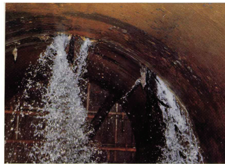
ヒューム管(φ2,200mm)の継ぎ手部破損による地下水流入(仙台市公共下水道 七北田川右岸幹線)
