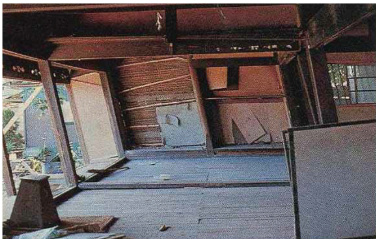
傾斜した木造民家(市内 沖野)
