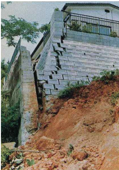
市内緑ヶ丘団地の崖崩れ
