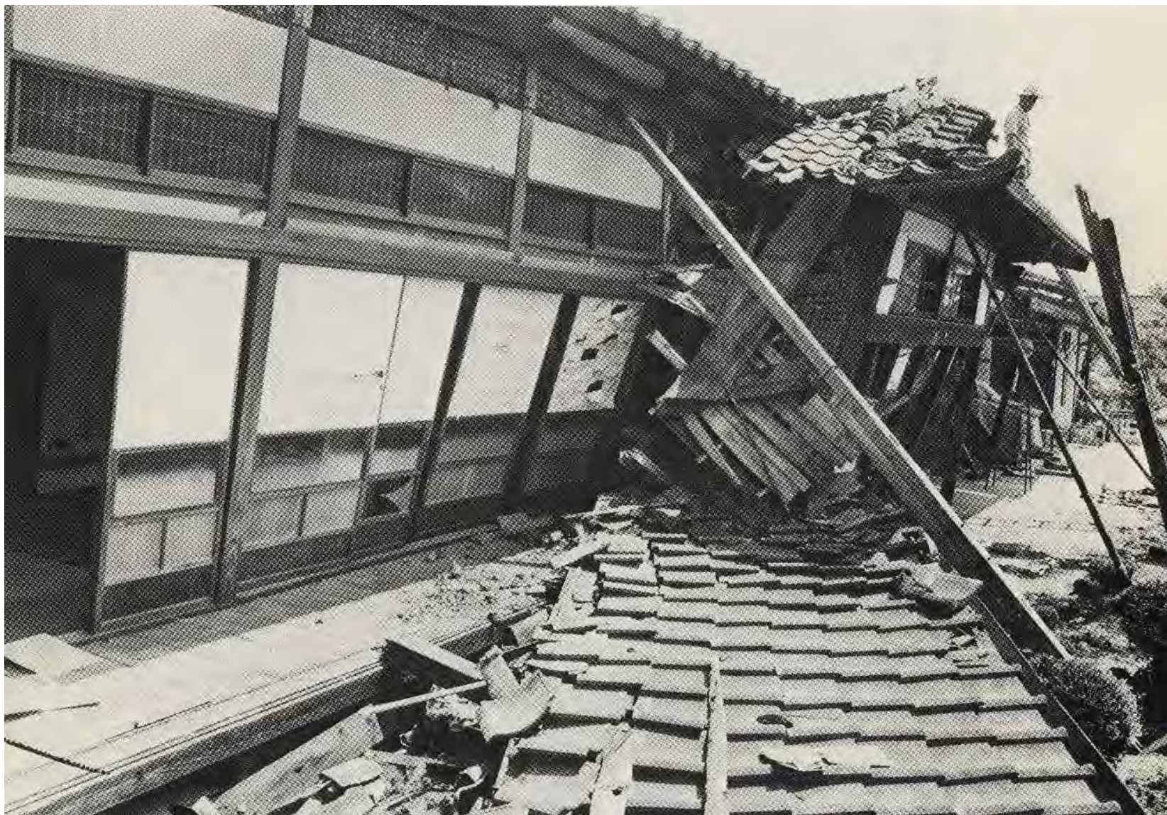
“支え”で崩壊を防ぐ古い農家（市内 六郷）。平野部では古い木造家屋の被害が目立ちました。
