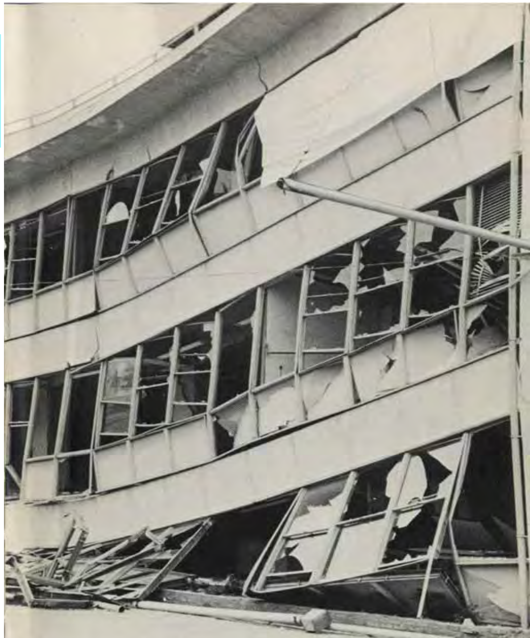
1階が押し潰され、全体が弓 なりに曲がったビル (市内 苦竹)
