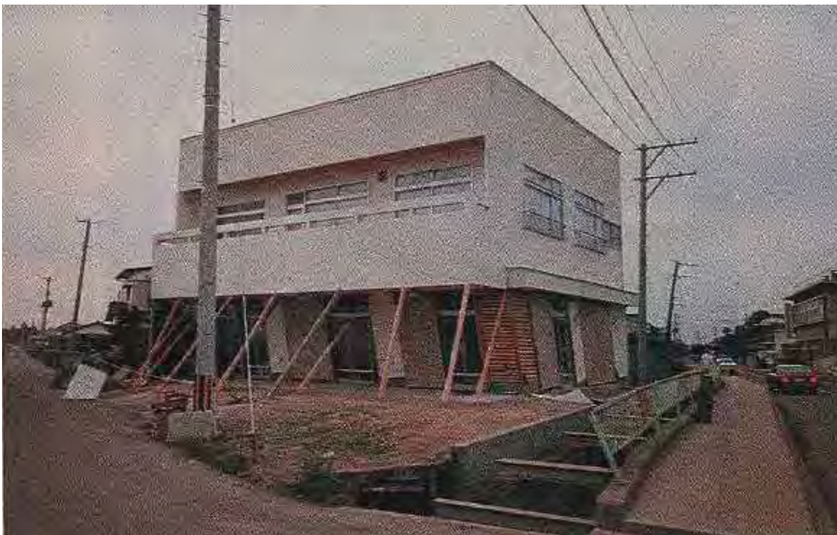
傾斜した木造民家 (市内 六郷)
