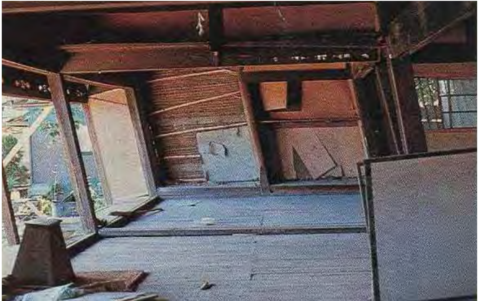
傾斜した木造民家 (市内 沖野)
