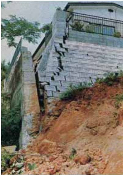
市内緑ヶ丘団地の崖崩れ
