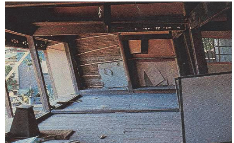
傾斜した木造民家(市内 沖野)。後背湿地に位置しているとみられる。
