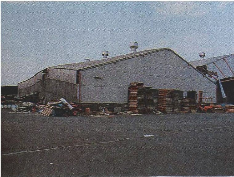
1階部分が崩壊した鉄骨造2階建倉庫（蒲町 仙台運輸倉庫）。後背湿地に位置しているとみられる。
