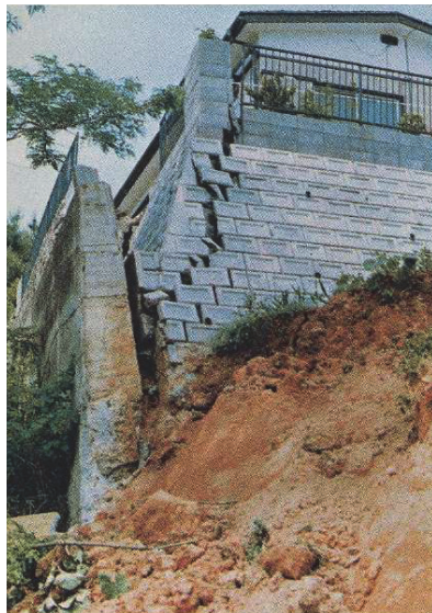
市内緑ヶ丘団地の崖崩れ
