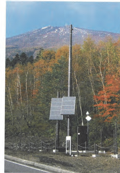
図2-15. 地震計と傾斜計が一体となった観測装置 (提供: 防災科学技術研究所)
