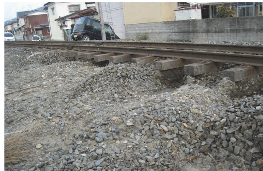
4.15. 津波で抉り取られた道床碎石
