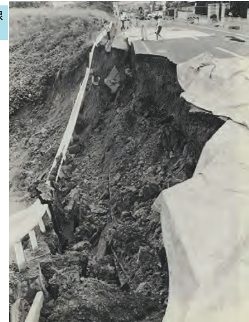
各所で寸断された幹線道路(市内 鶴ヶ谷)
