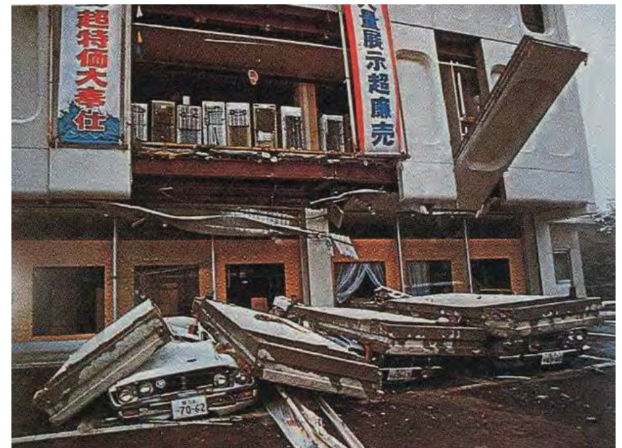
落下した外壁PCパネル (市内 七北田 ホームセンター佐々木 鉄骨造3階建 一部4階)
