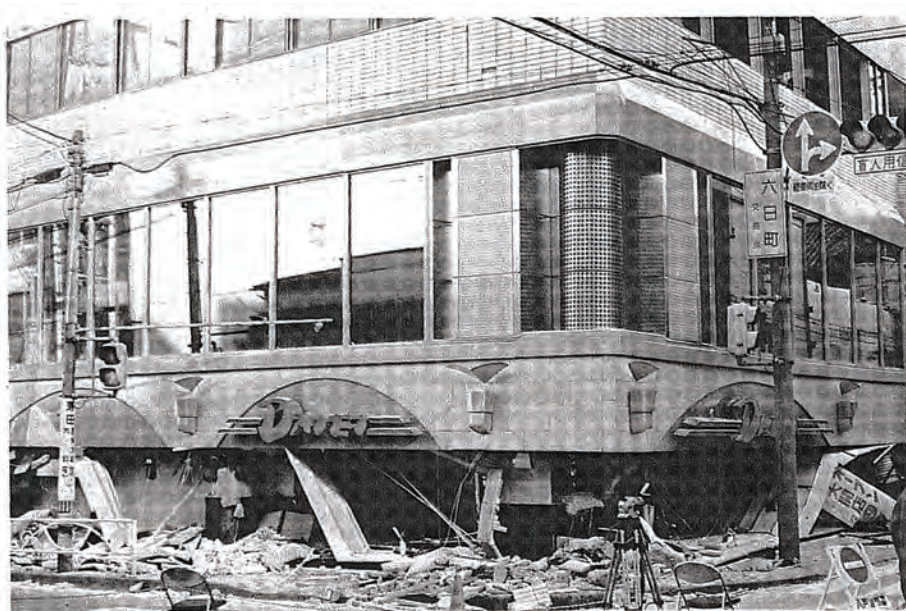
▲パチンコ店全景。約4メートルの天井部が低 いところで80センチメートルまで落下。 The ceiling fell down from 4m to 80cm ※写真は、地震発生後、撮影されたものである。
