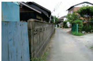
倒れかかっているブロック塀と避難路
