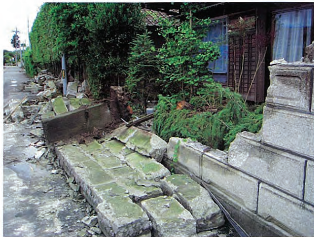
口絵-58 ブロック塀の倒壊 (河南町広瀬地区)
